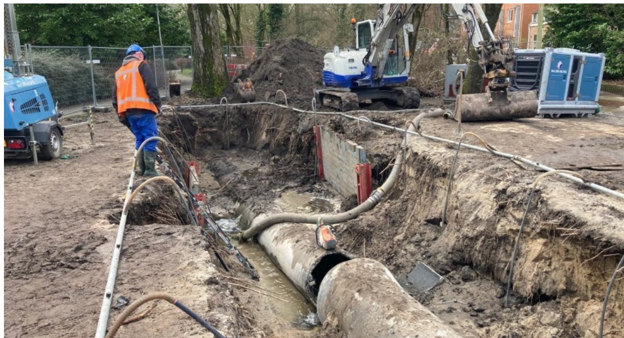
Wortels van een boom bovenop een AWTL hebben een mof-spieverbinding beschadigd – bron afbeelding: Waternet.
