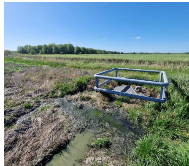
Bescherming voor een automatische ontluister op een persleiding - bron afbeelding: Waterschap Noorderzijlvest.
