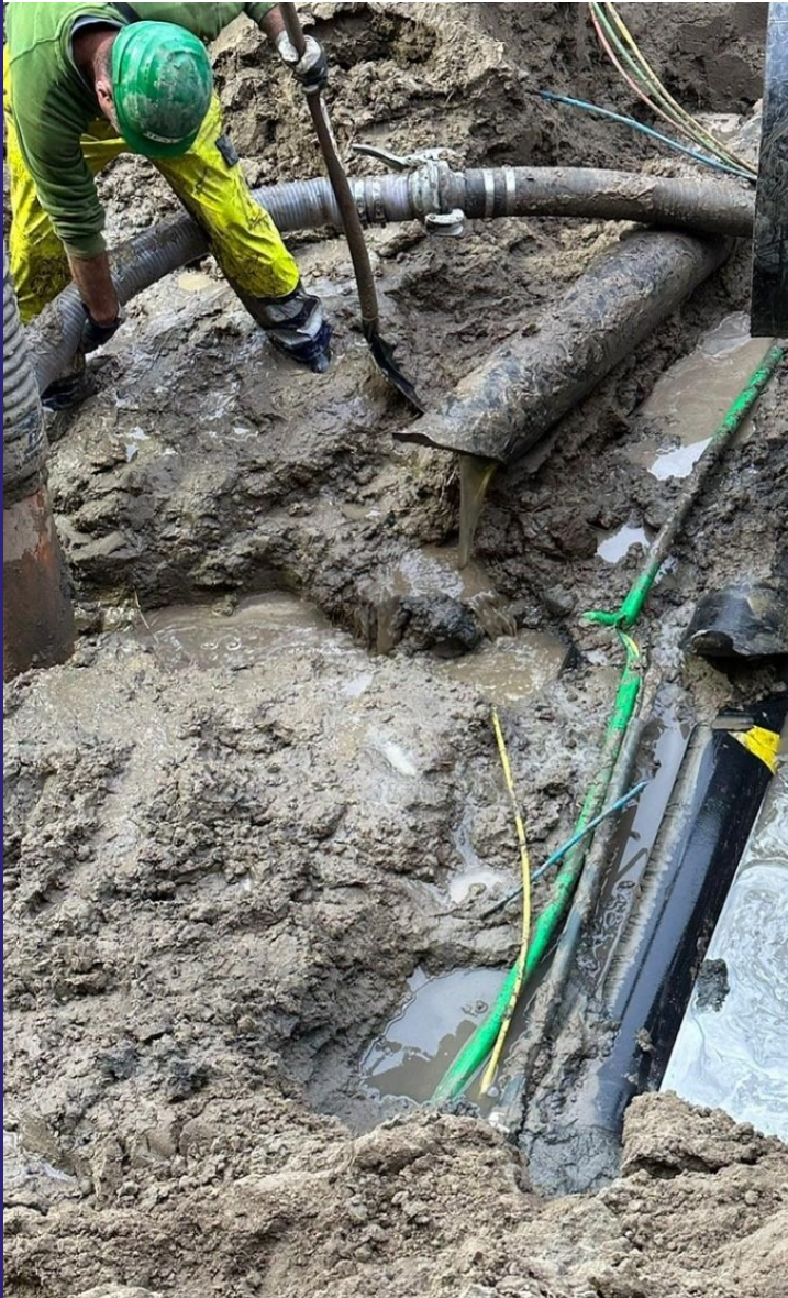
Graafwerkzaamheden bij de aanleg van kabels en leidingen hebben een AWTL en diverse andere kabels en leidingen beschadigd – bron afbeelding: gemeente Rotterdam.
