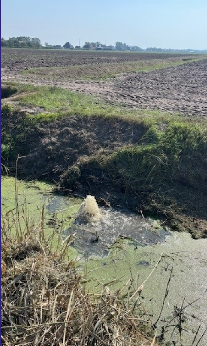
AWTL onder een watergang is door werkzaamheden beschadigd – bron afbeelding: Waterschap Hollands Noorderkwartier.
