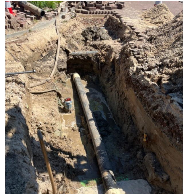
Ondergraven van de AWTL zonder aanbrengen van goede ondersteuning heeft tot lekkage geleid – bron afbeelding: waterschap Noorderzijlvest.
