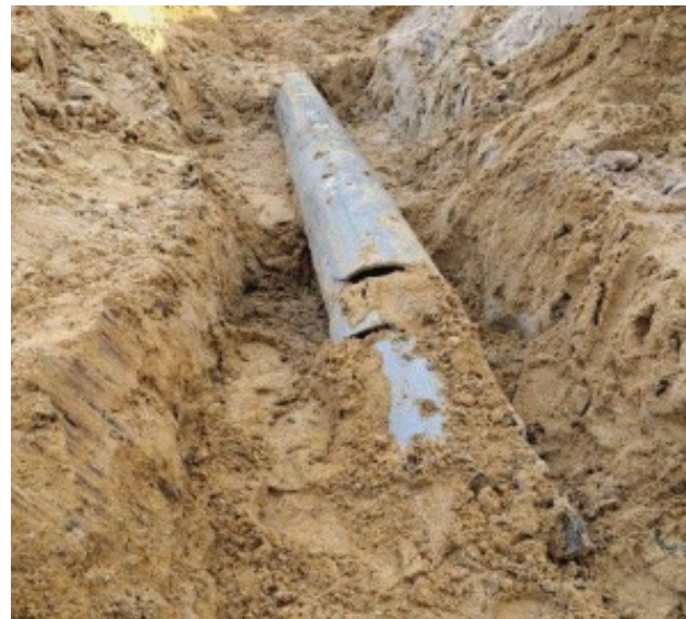
Door een freesmachine is bij het aanleggen van drainage een AWTL beschadigd – bron afbeelding: Waterschap Aa en Maas.
